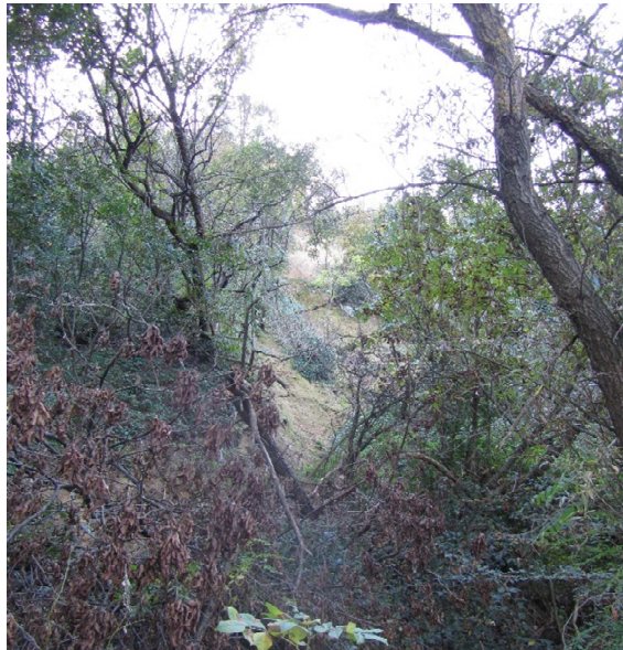
Slika 40 Pojava novog klizišta na lokaciji Lovka – velika količina raslinja na lokaciji predstavlja otegotnu okolnost za obavljanje mjerenje
