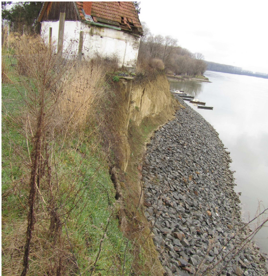
Slika 58 Ugroženi objekti kao posljedica erozije
