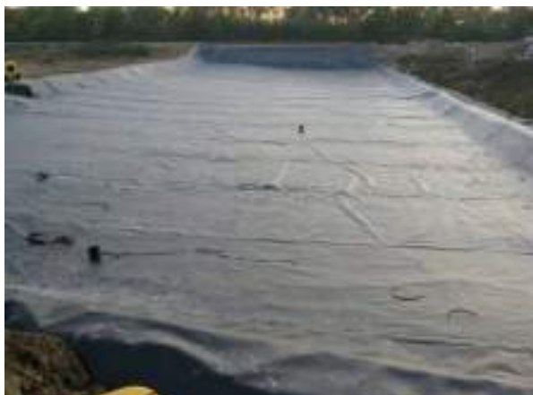
Foto 15. Uređenje nepropusne podloge u kaseti za odlaganje otpada na odlagalištu Mrcalinska Dubrava.
