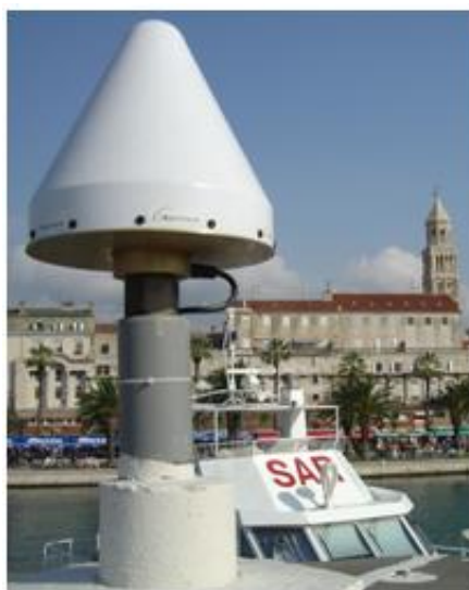
Slika 5.7. CGPS antena postavljena na krovu mareografske postaje Split – Luka 2004. godine.
