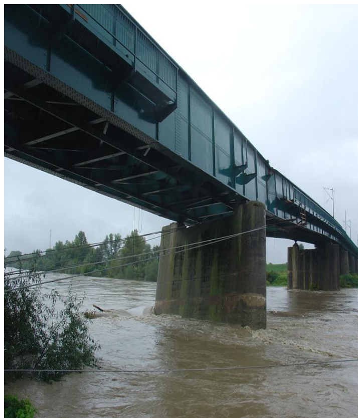
Slika 4.2-2: Lijevi stup je izgubio stabilnost (Snimljeno u 9.mj.2010., foto Oskoruš)
