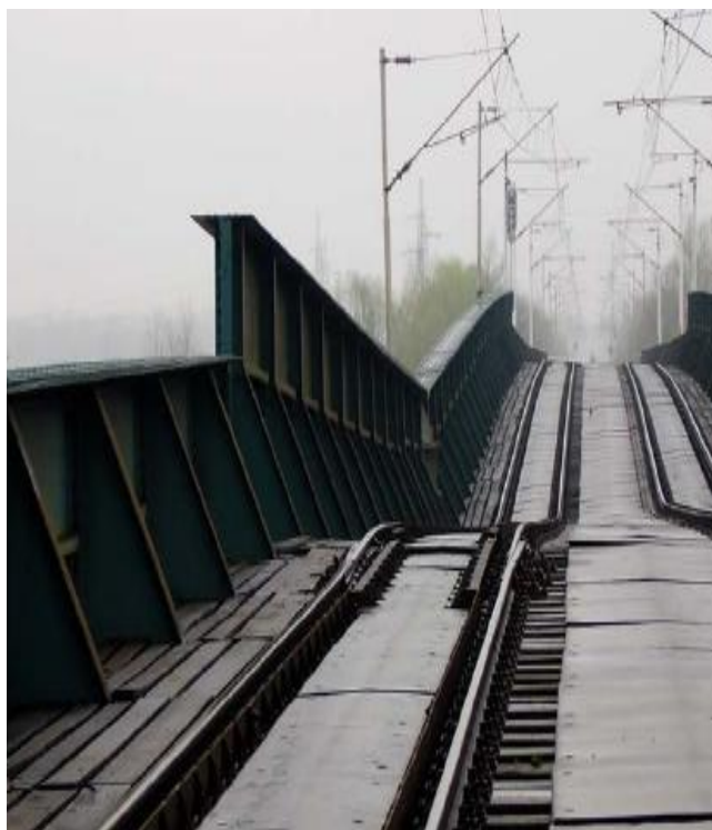
Slika 4.2-3: Deformirana gornja konstrukcija (Snimljeno u 3.mj.2009., HŽ Infrastruktura)
