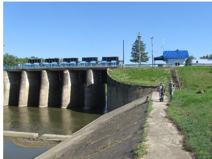
Slika 1b: - hidrotehničke građevine
