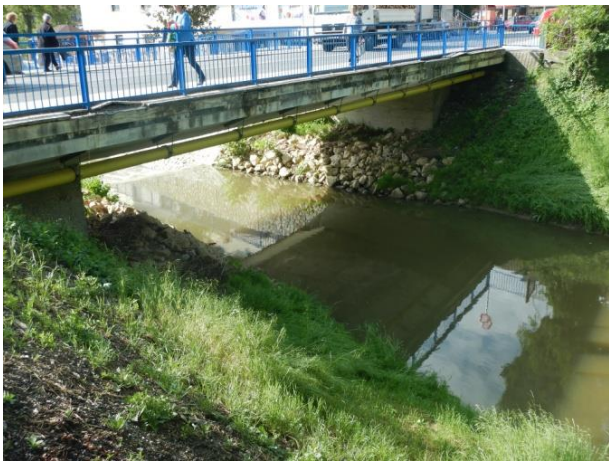
Slika 1c: Kameni nabačaj ispod mosta
