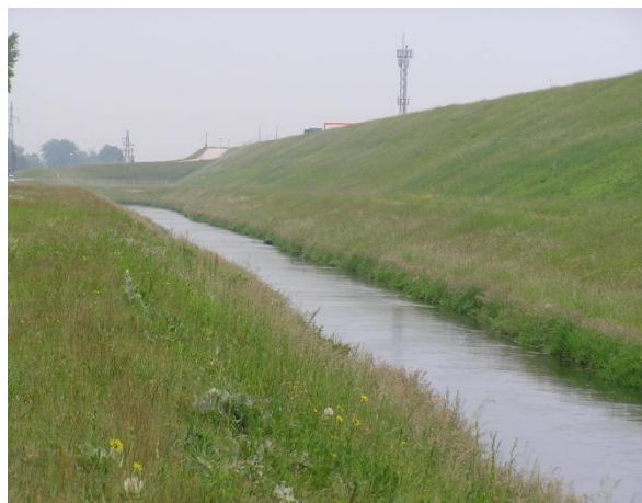
Slika 104.1d: Lijevi obodni kanal HE Čakovec, Novo Selo na Dravi – pogled nizvodno
