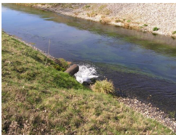
Slika 61.1c: Obodni kanal (desni drenažni) HE Dubrava, Dubovac – obale i korito kanala i drenaža okolnog poljoprivrednog zemljišta
