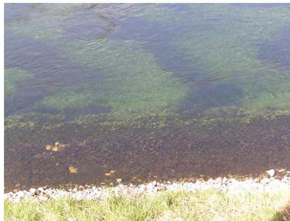
Slika 61.1b: Obodni kanal (desni drenažni) HE Dubrava, Dubovac – struktura obale i korita kanala
