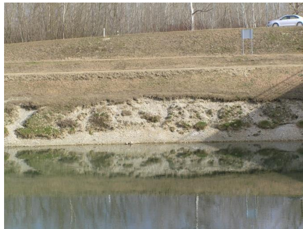
Slika 58.1d: Odvodni kanal HE Dubrava, D. Vidovec – detalj erozije lijeve obale uslijed stacionarnog rada hidroelektrane
