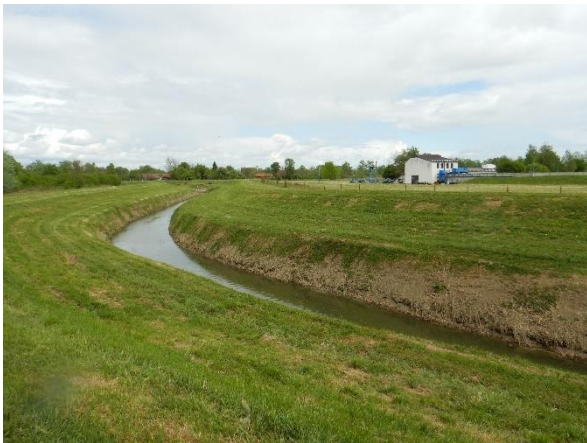
Slika 30.1c: Lonja, nizvodno od Ivanić Grada – tragovi erozije i zaobalje
