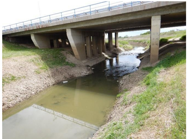
Slika 30.1d: Lonja, nizvodno od Ivanić Grada – utvrđenost obale
