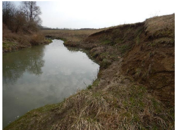
Slika 7.1d: Bijela Rijeka, cesta Gaj - Parmakovac – erozijski procesi uzvodno od odsječka
