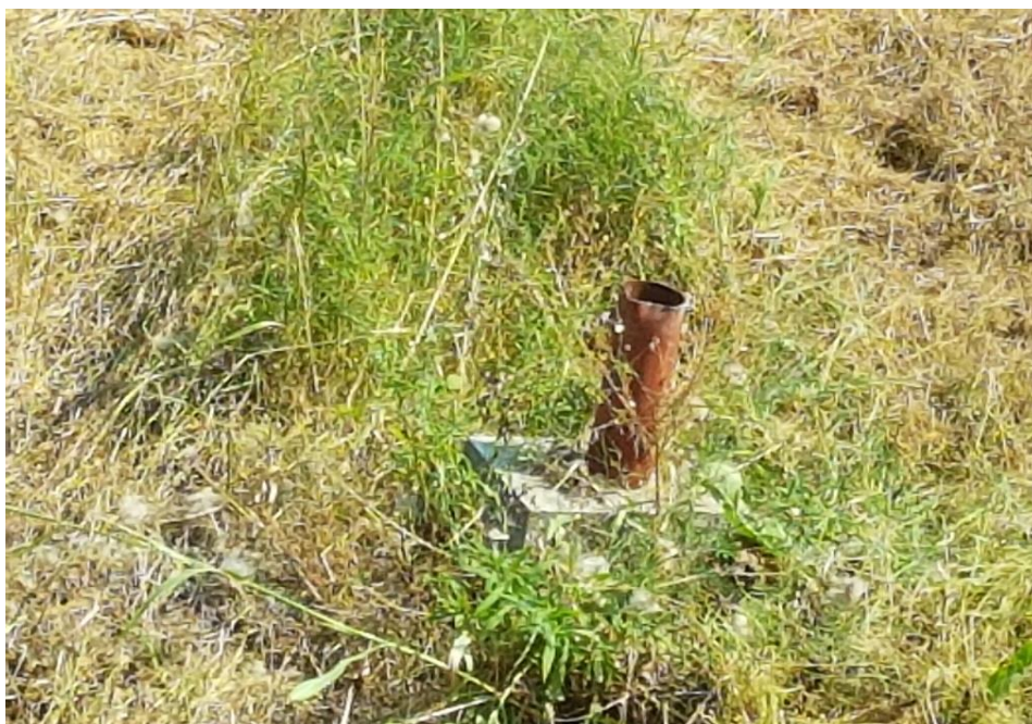
Oštećeni pijezometar KV3 ( rujan 2018)
