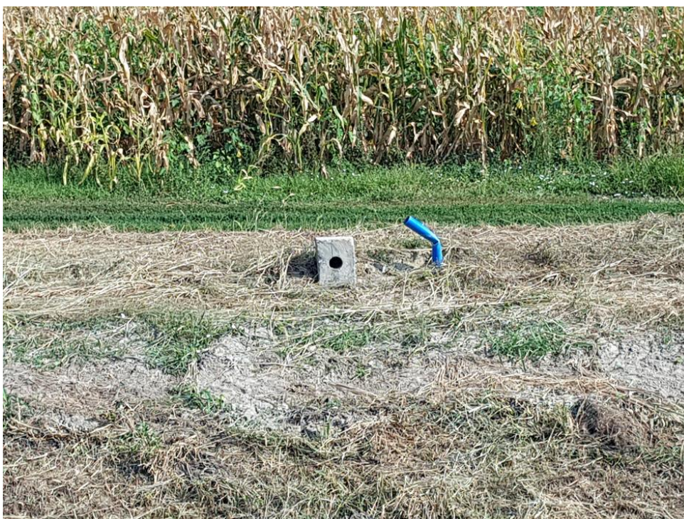
Oštećeni pijezometar SU2 ( rujn, 2018)
