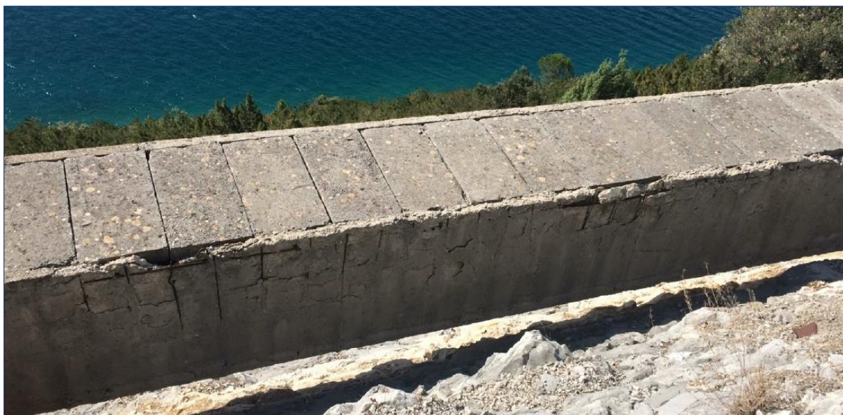
Slika 6-58 Dio rasponske konstrukcije s uočenom degradacijom betona i vidljivom korozijom armature
