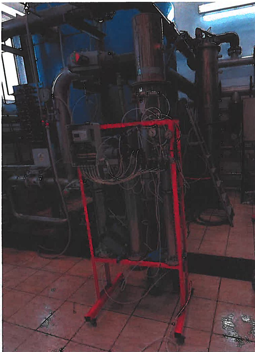
Slika 5.1.4. Fotografija pilot postrojenja na Vodocrpilištu Gaj nakon modifikacije sustava za aeraciju sukladno shematskom prikazu na slici 5.1.3.
