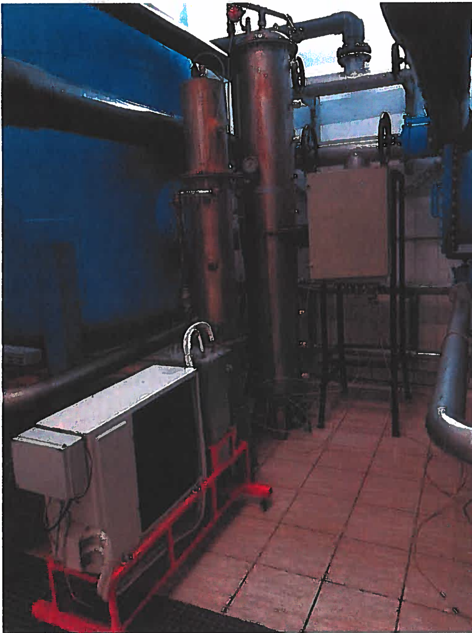
Slika 5.1.2. Fotografija instaliranog pilot postrojenja na Vodocrpilištu Gaj
