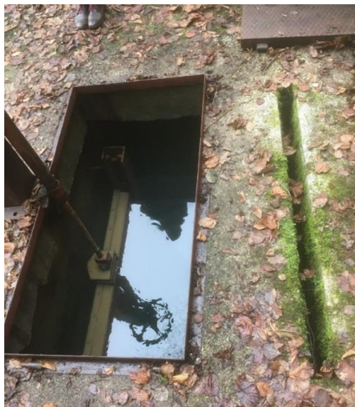
Slika 3.4 Pločasti zatvarač na zahvatnom objektu
