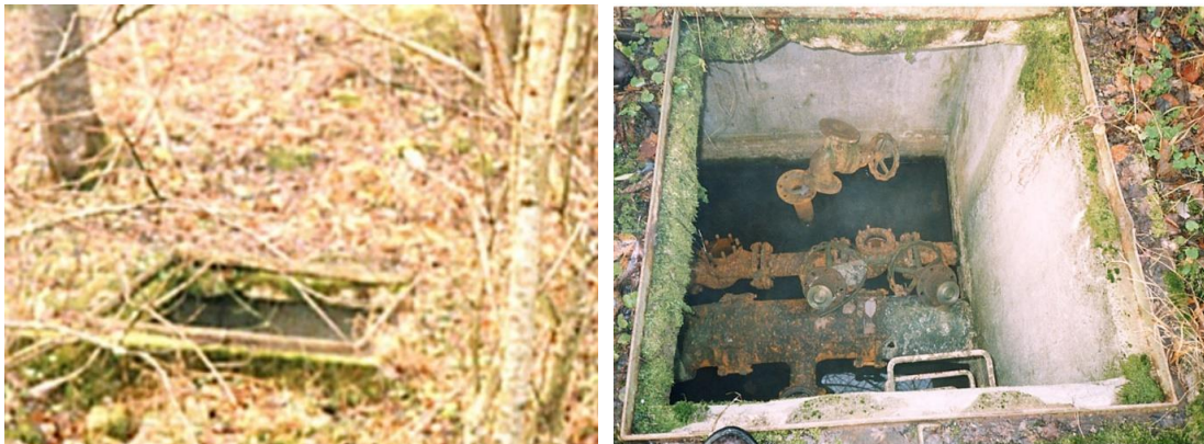
Slika 8.22: Revizionna okna na trasi cjevovoda za transport kerozina do aerodroma Željava (Arhivska fotografija iz 2003. godine)
