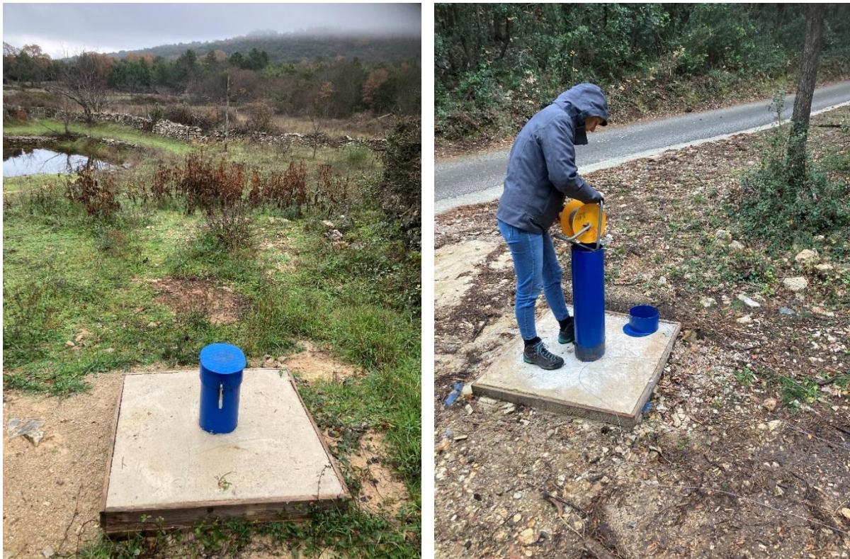
Slika 2.4.3. Završni dio izvedenih piezometara Valun - PZV (lijevo) i Martinšćica - PZM (desno)
