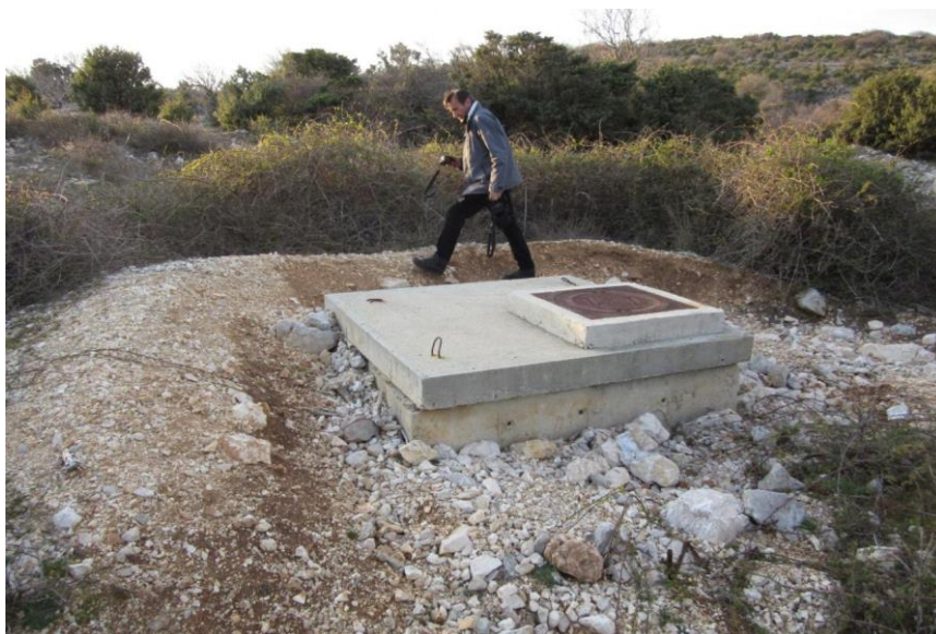
Slika 3.5. Odvodno okno separator ulja i masti uz državnu cestu D100 na otoku Cresu s vidljivim tragovima intenzivnog prelijevanja oborinskih voda koje su čak pomaknule betonsku ploču
