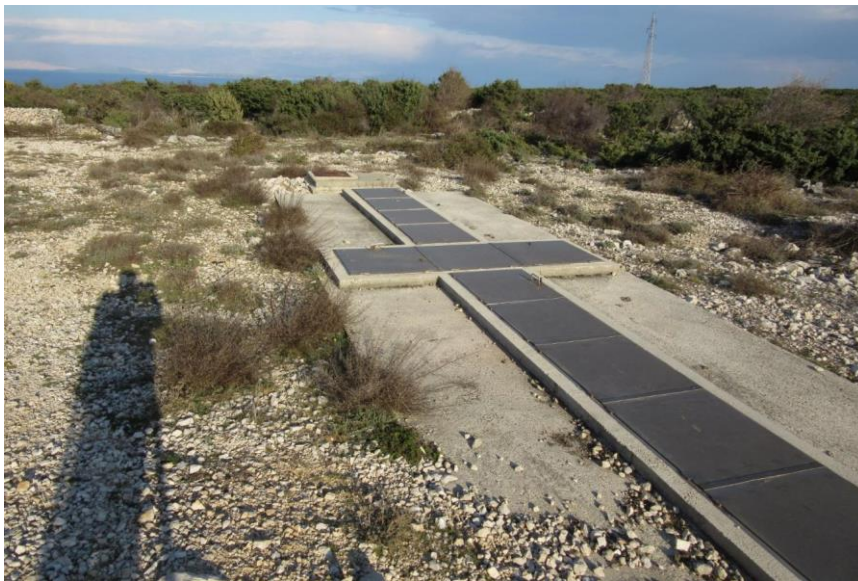
Slika 3.4. Separator ulja i masti uz državnu cestu D100 na otoku Cresu
