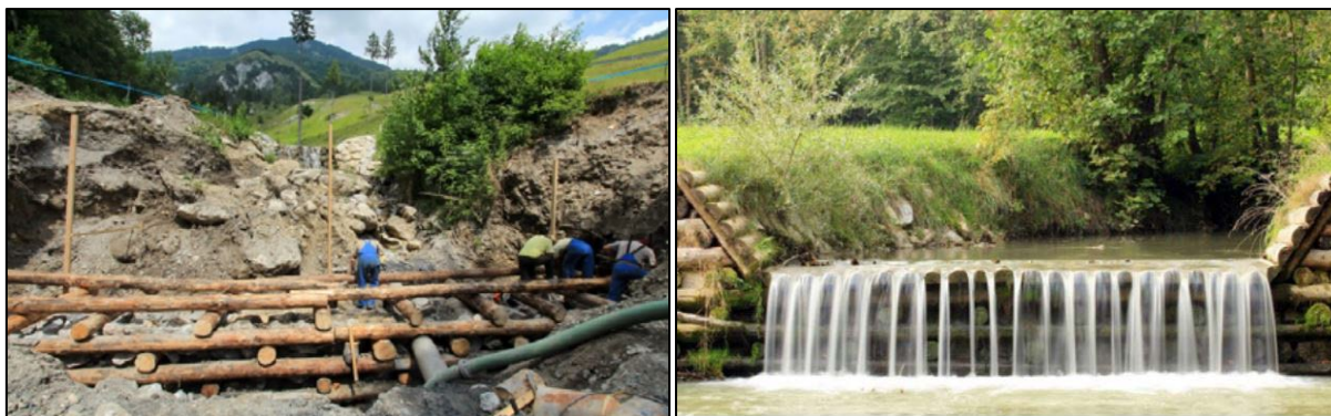
Slika 9. Izgradnja bujične pregrade na bujici Buljičici (lijevo) i primjer izgrađenog objekta na rijeci Pšati (desno) [13]
