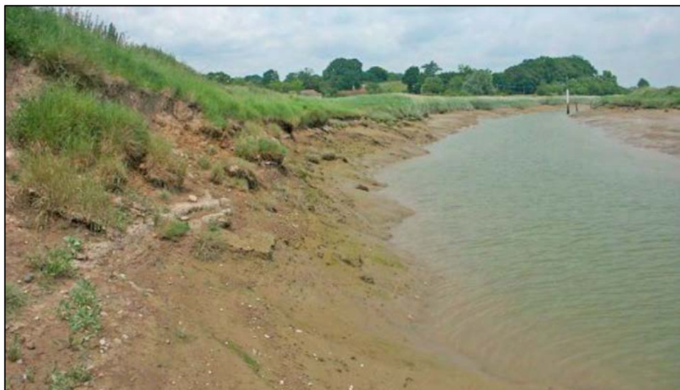
Slika 11. Erodirana obala rijeke Rother prije izgradnje obaloutvrde, 2004. [9]
