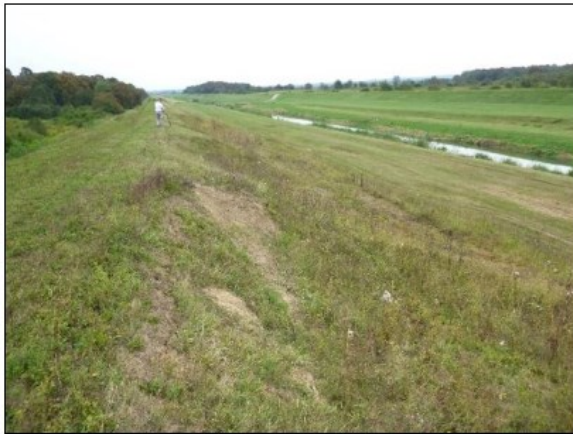
T 13: Niz od nekoliko uzastopnih klizišta na priobalnom pokosu nasipa. Cijela zona klizanja dugačka je preko 120 m.
