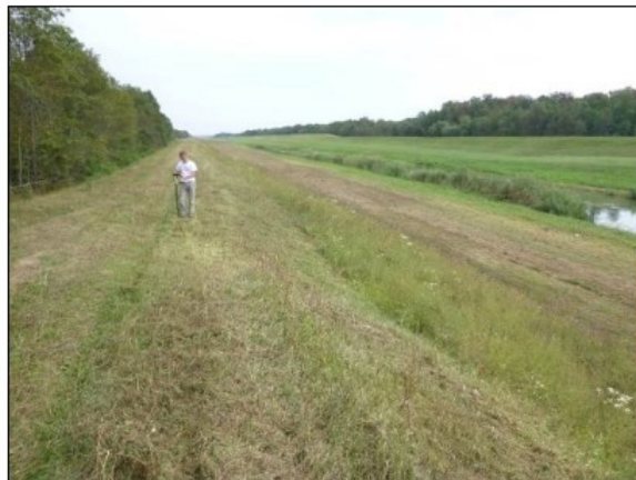
T 14: Slijeganje po cijeloj širini krune nasipa dubine 40 cm i na duljini krune od 20-ak metara. Slijeganje je djelomično vidljivo i u gornjem dijelu priobalnog pokosa.
