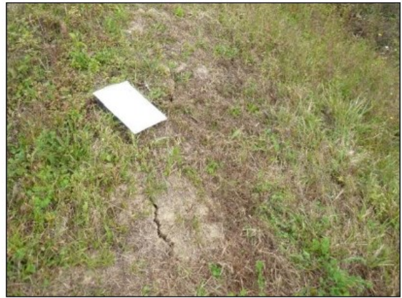
T 13: Vlačne pukotine uz rubove trenutnih klizišta koje upućuju na mogućnost napredovanja klizanja prema kruni nasipa i/ili otvaranje novih kliznih ploha bočno na pokosu.
