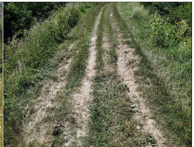
Slika 3.3 Oštećena kruna nasipa, vidljiva površinska erozija i slijeganje rubnih dijelova kruna, oštećenje nasipa vozilima
