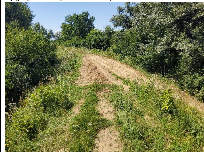
Slika 3.4 Oštećenje nasipa na mjestu gdje se poljski put penje na nasip, pogled prema početku trase
