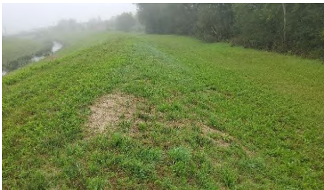
Slika 3.2 Oštećena kruna nasipa, vidljiva površinska erozija i slijeganje rubnih dijelova krune nasipa za cca 30 cm – desni nasip, stacionaža cca km 0+730
