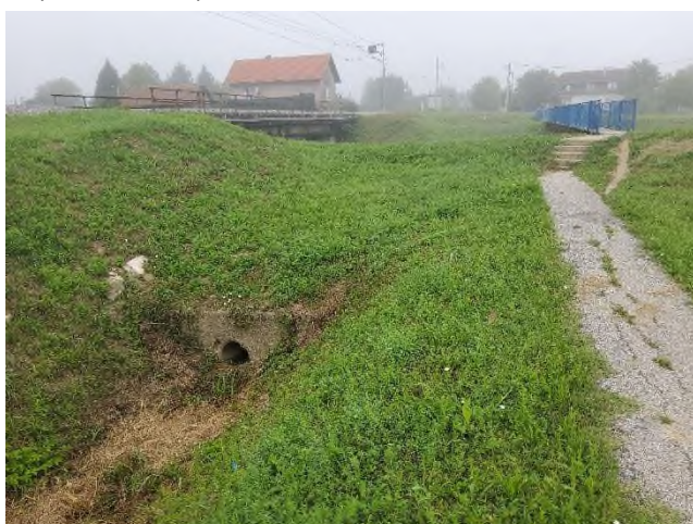
Slika 3.8 Denivelacija krune nasipa kod željezničkog mosta – desni nasip, stacionaža cca km 1+440
