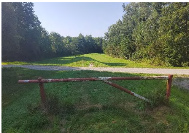
Slika 3.6 Lokalna cesta prelazi preko nasipa, denivelacija krune nasipa – desni nasip, stacionaža cca km 5+080
