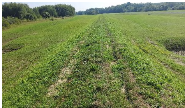
Slika 3.3 Oštećena kruna nasipa, vidljiva površinska erozija i slijeganje rubnih dijelova krune, oštećenje nasipa vozilima, razmekšana dionica nasipa iznad propusta – lijevi nasip, stacionaža cca km 1+550
