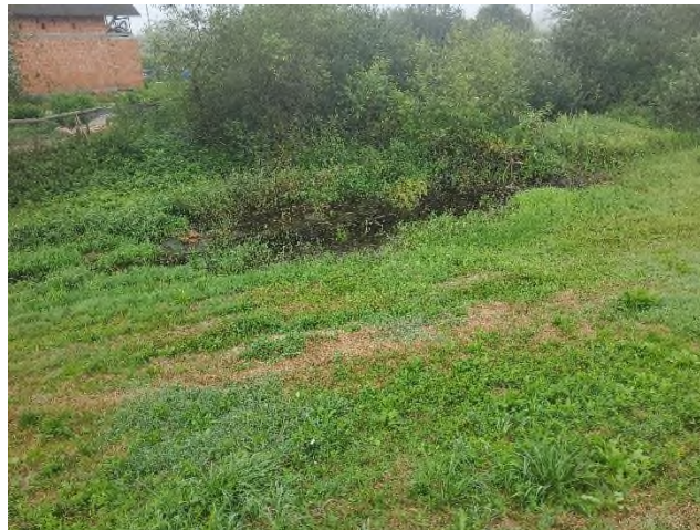
Slika 3.11 Zadržavanje vode u starom koritu potoka Lekenij – desni nasip, stacionaža cca od km 0+470 do 0+550
