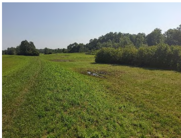
Slika 3.13 Zadržavanje vode u inundacijskom pojasu – lijevi nasip, stacionaža cca od km 1+900 do 2+500
