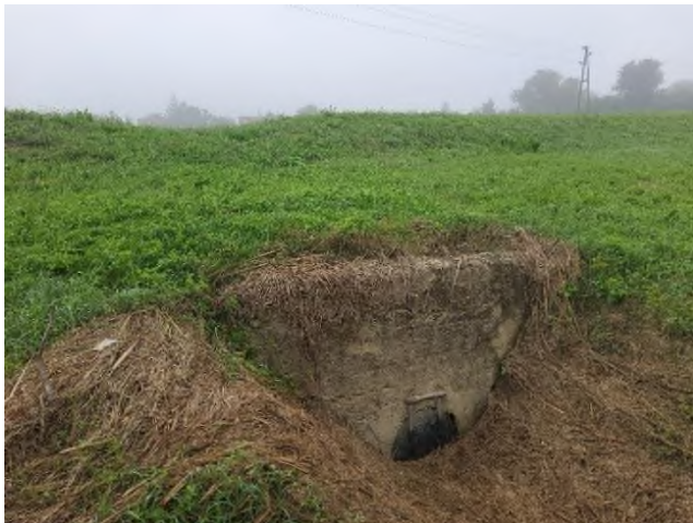
Slika 3.4 Denivelacija krune nasipa iznad betonskog propusta – desni nasip, stacionaža cca km 0+300
