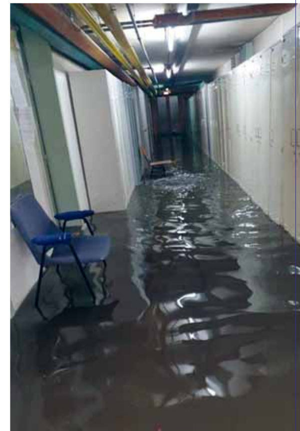
Poplavljeni objekti, Klaićeva bolnica Zagreb
