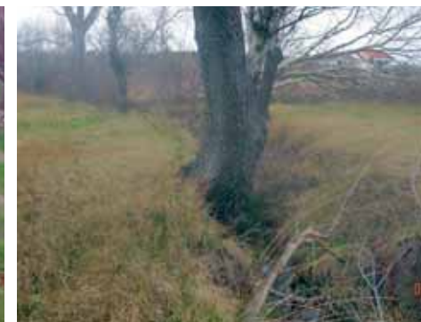
Korito bujičnog vodotoka Koštanica suženo raširenom niskom i visokom vegetacijom
