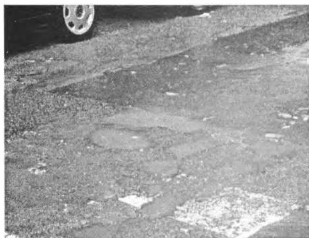
Slika 5: Posljedica manjkave odvodnje – oštećenja oblika udarne jame
