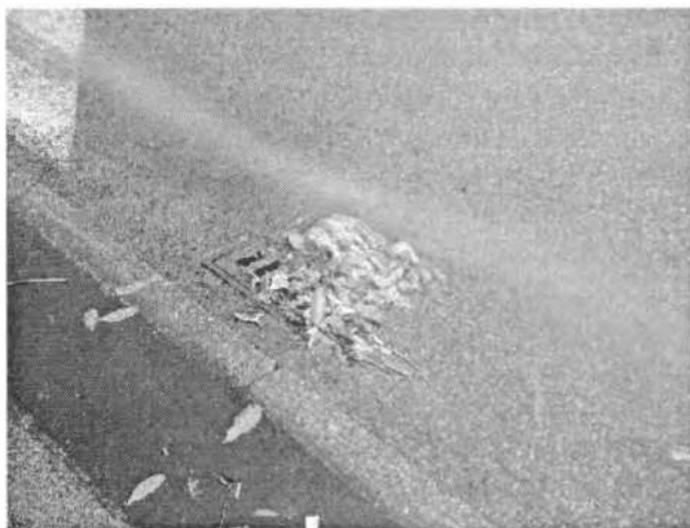
Slika 3: Jedan od problema odvodnje prometnica u gradu
