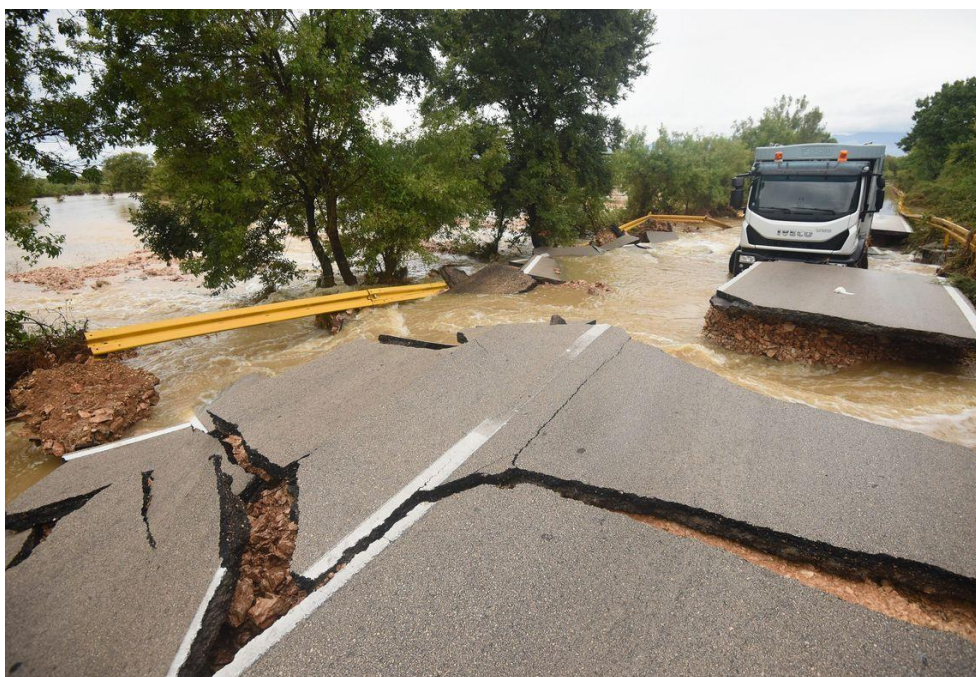
Slika 59 Oštećenje ceste Zadar - Ražanac, 11. rujan 2017. godine
