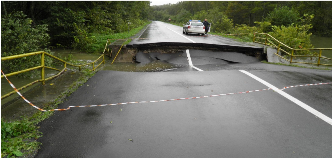
Sl. 2.6. Oštećen most preko rijeke Lonje (2010.)
